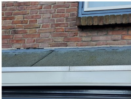
Locatie: Extérieur, Woning, Voorgevel Ontbrekend voegwerk en trapvormige scheurvormingen rechtsonder raamkozijn 1e verdieping naar linksboven deurkozijn
